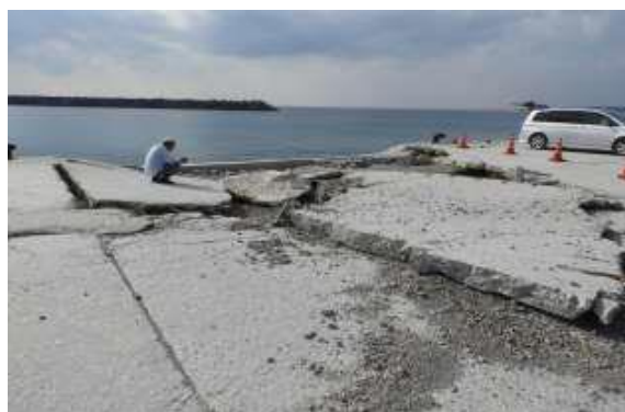
台風で壊れてしまった塩川港の護岸。 この港の管理者は、沖縄県です。
